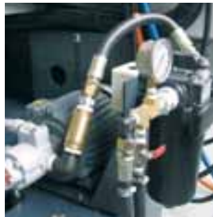
Блок подачи СОЖ через шпиндель, 18 бар
